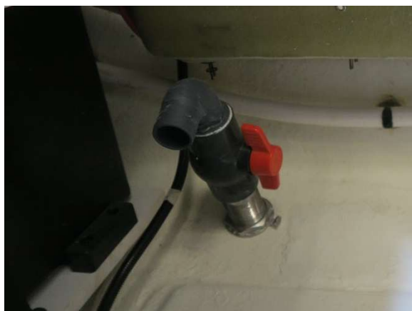
Vanne de décharge
