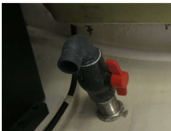
Détails de la vanne eaux noires
