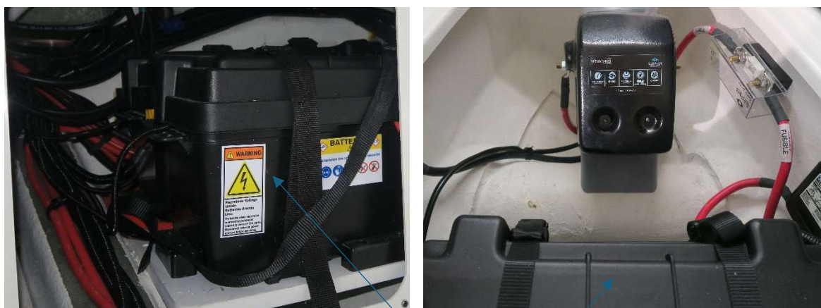
Détails des batteries (services et moteurs / propulseur d'étrave-Guindeau)
